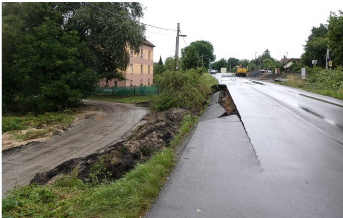
Obr. č. 1: Pohled na porušený úsek
